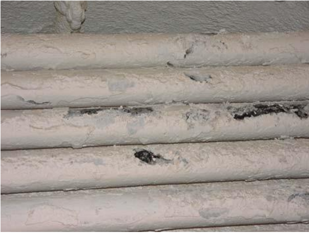
Alev borularının üstündeki kazantaşı yumuşaktır ve temizlemesi kolaydır
