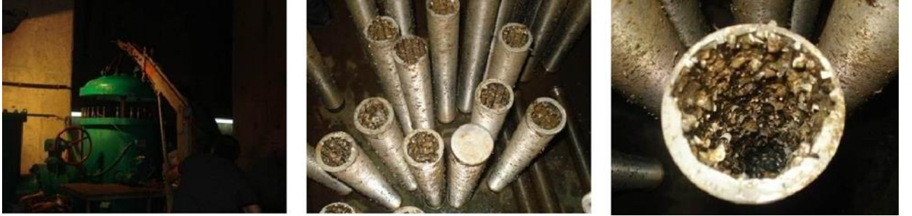
Şekil 8 - Atatürk Barajı HES soğutma serpantinleri
